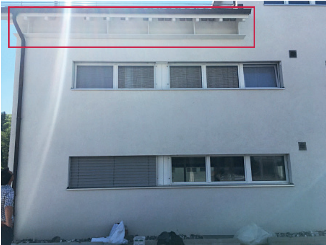
Abbildung 1: Kotbretter (rot umrandet) zum Schutz der Fenster-simse und der Fenster.
